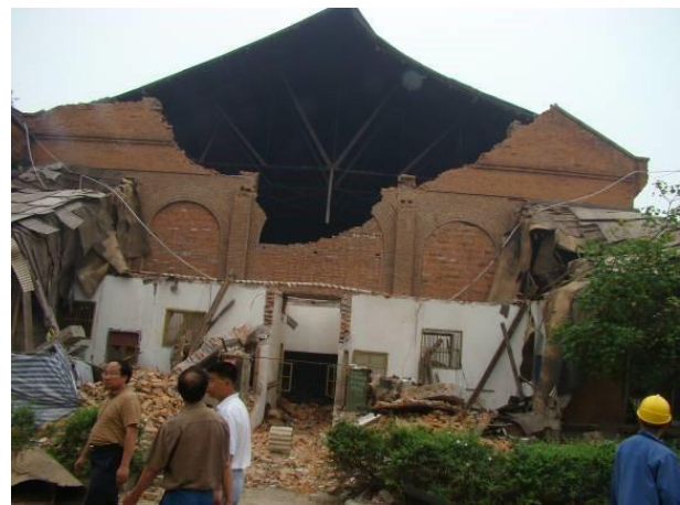
(d) Local collapse of maintenance wall
